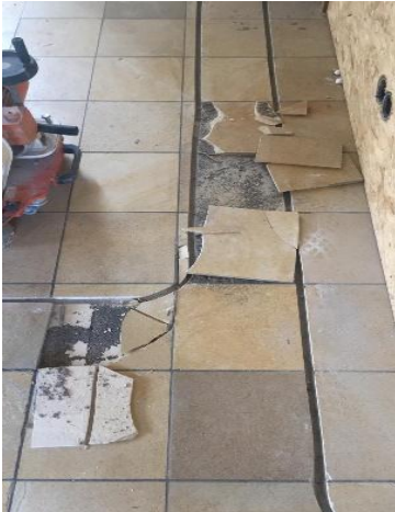
Voorbeeld losgekomen tegelvloer
